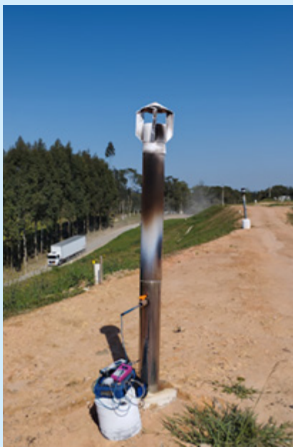
Figura 4 - Dispositivo metálico para queima de biogás no topo de drenos verticais.
