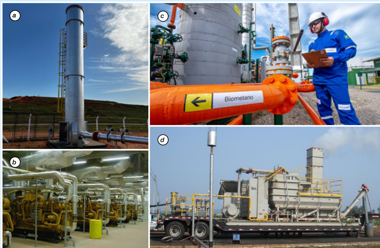
Figura 5 - Aproveitamento do metano de biogás de aterros: (a) queima em flare enclausurado, (b) queima em motores à combustão para geração de energia elétrica, (c) geração de biometano e (d) evaporação do chorume.
