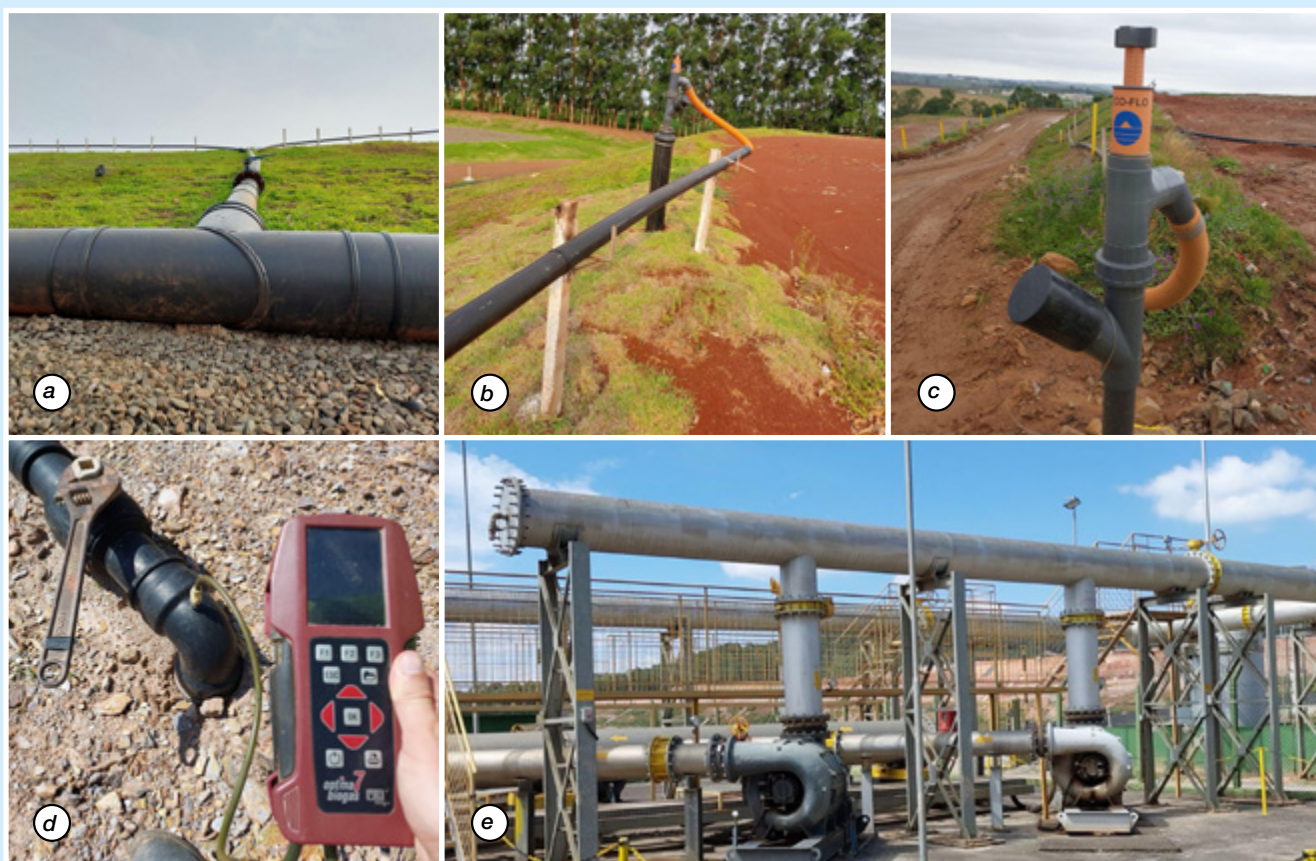
Figura 6 - Elementos da rede de captação forçada de biogás de aterros sanitários: (a) linhas principal e secundária; (b) tubulação apoiada com cavaletes; (c) cabeçote interligando a rede interna e externa de captação do biogás; (d) realização de monitoramento da rede de captação de biogás com analisador de gás portátil; (e) sopradores para sucção do biogás.
