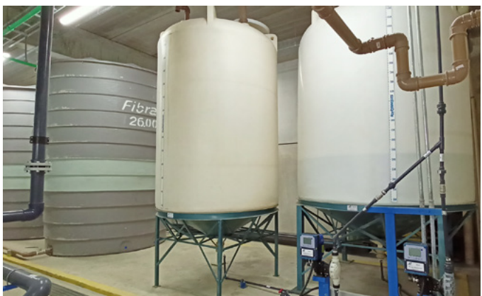
Equipamentos da Estação de Tratamento de Águas Pluviais
